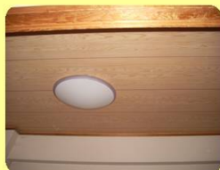
天井より結露
